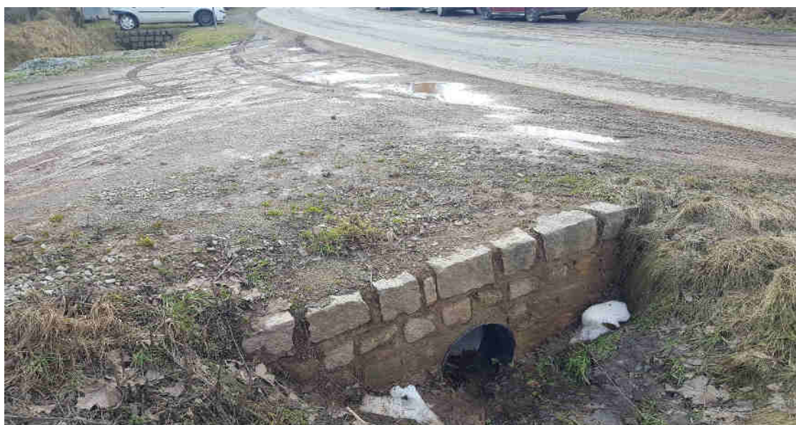
zdj. 3 Istniejąca droga w m. Gostków dz. 456 – przepust na włączeniu do dr. powiatowej
